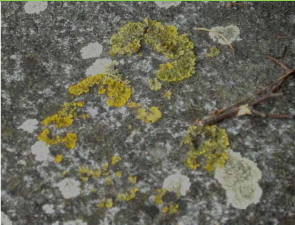
Geel korstmoss op beton brug Maaswaalkanaal
